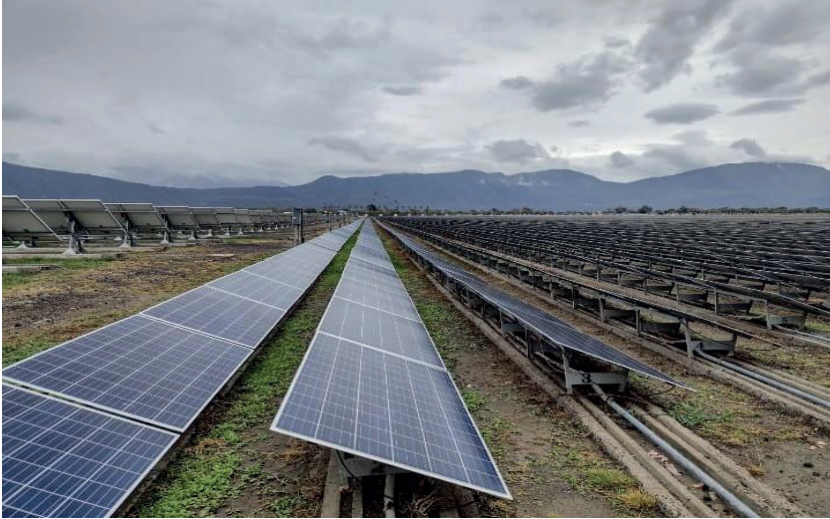
Foto 2. Parque solar fotovoltaico Fortius (Zacoalco de Torres).
